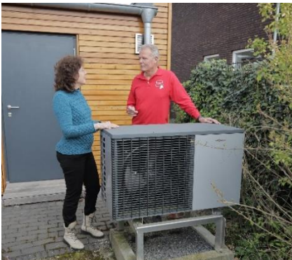
Foto: Met een duurzaamheidslening kun je bijvoorbeeld een warmtepomp aanschaffen. Met de ISDE-subsidie krijg je ook nog een deel vergoed.
